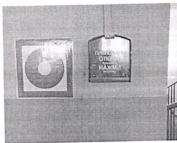
Фото №15 Визуальные средства путей эвакуации
