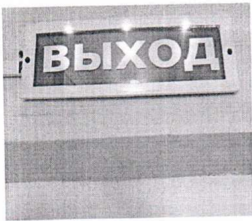
Фото № 12 Визуальные средства путей эвакуации
